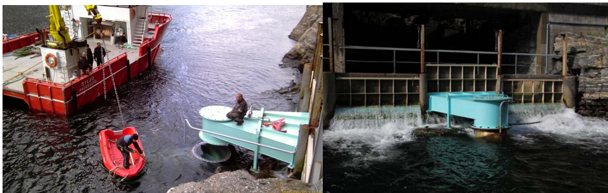
Figur 10. Anlegg for føring av ferskvann fra utløp i kraftanlegg. Under samlekasse på venstre bilde monteres røret som fører vannet til 34 meters dyp (se figur 9).
